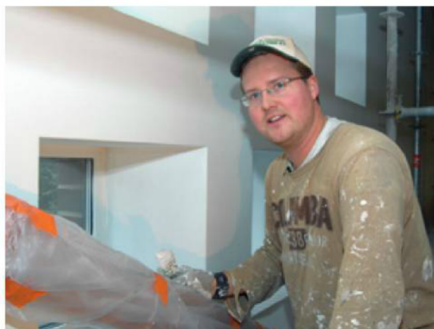
† Jyrki Pohjonen viimeistelemässä parvelle johtavan porraskäytävän maalauksia. – Maalarina olen ollut vuodesta 2000, kertoi Jyrki.
